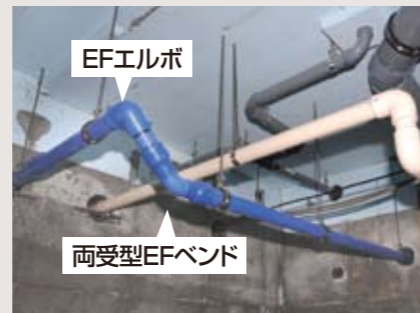
地下ピット内の給水配管 ねじ式のクランプ付き「EFエルボ」と 両受型「EF45°バンド」
